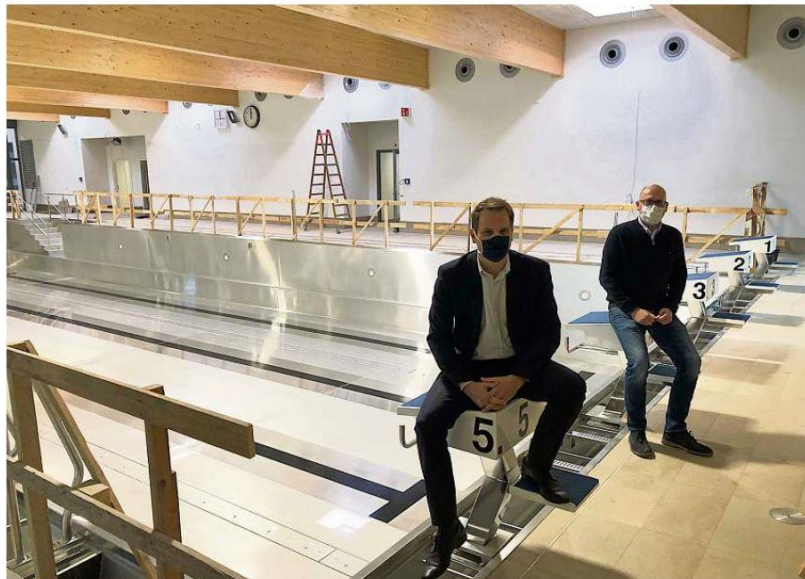
Stadtbad-Geschäftsführer Christoph Schlupkoth (vorn) und Bauleiter Christian Tschepella vor dem 25-Meter-Becken aus Edelstahl.
